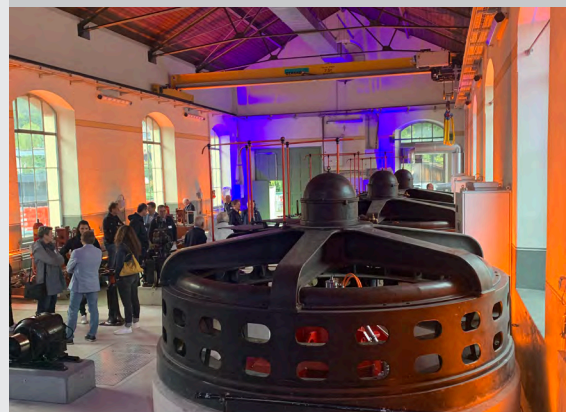
Wasserkraftwek der IBI Interlaken zwischen Aare und Schiffskanal. Foto: Martin Alexander Moser, 2022
