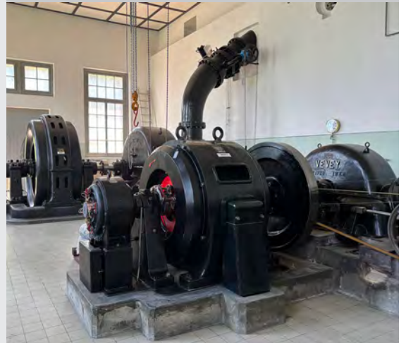
Der Maschinensaal des historischen Kraftwerks Schattenhalb 2. Foto: Edith Biedermann
