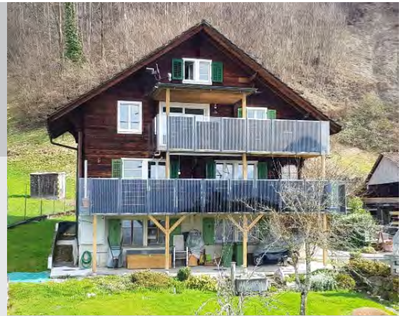
Unbefriedigendes Beispiel für Solarpanels an der Hausfassade. Foto: Fässler AG Metallbau
