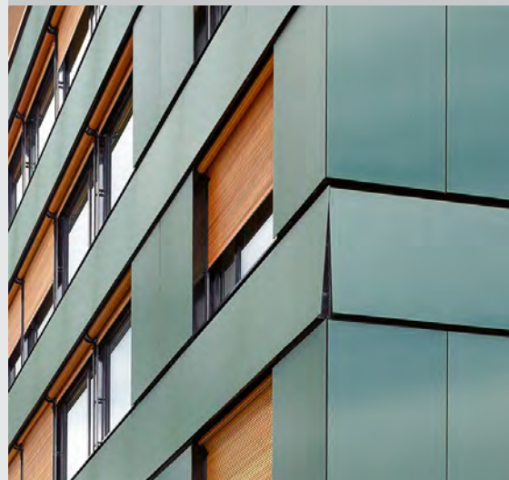
Mehrfamilienhaus mit neuer Verkleidung aus farbigen Solarplatten. Foto: Ansgar Staudt Architekten, Basel
